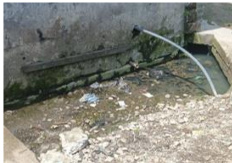
Gambar 2. Kondisi Jaringan Air Bersih di Kec Medan Tembung
